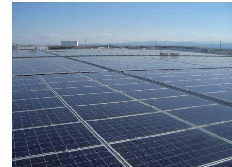
太陽光発電パネル：伊勢崎市内の自社倉庫2カ所にて太陽光発電を実施
